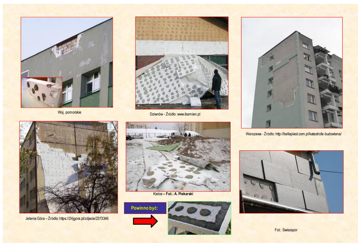
Fot. 13÷18 Skutki błędów wykonawstwa prac dociepleniowych
